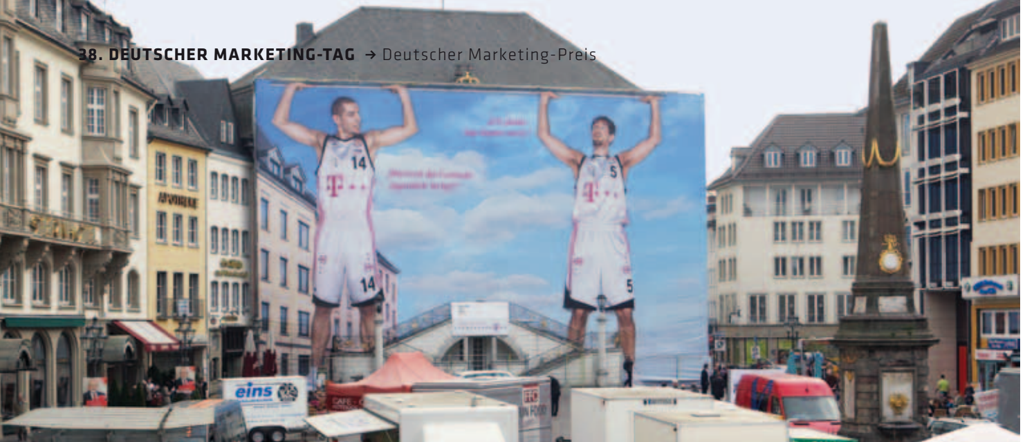
Spiel mit Optik und Emotionen: Mit wechselnden Riesenplakaten verhüllt die Telekom das Bonner Rathaus während der Renovierungsarbeiten. Den Auftakt machte dieses Motiv mit Spielern der Bundesliga-Mannschaft Telekom Baskets Bonn, die quasi das Dach des Gebäudes stützen.
